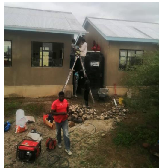
Teamet er i fuld gang med at sætte vandtanke og tagrender op på skolen. Der er ingen strøm så de har selv en generator med. Man skal huske meget.
